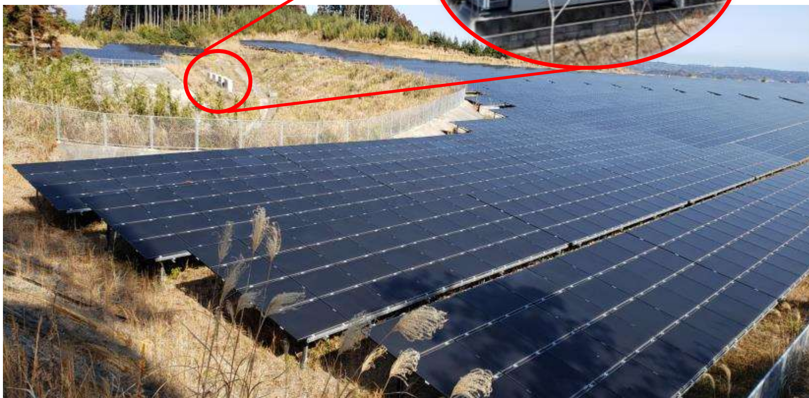
集中型パワーコンディショナの例（宮崎県某太陽光発電所）
